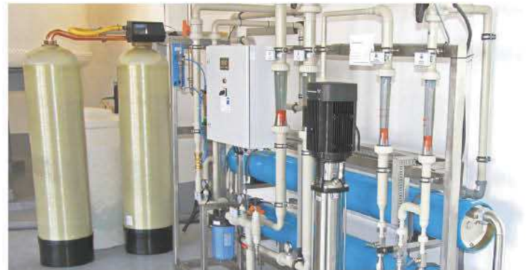
Wasseraufbereitungsanlagen können bei Naturkatastrophen oder in wasserarmen Gebieten eingesetzt werden. Fotos (2): Rabmer
